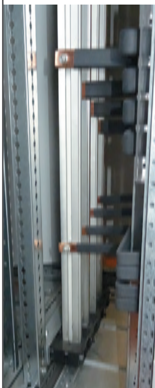
Шины, установленные в кабельной секции.
